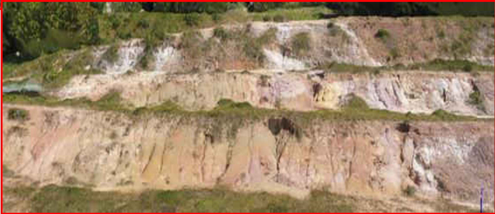
Ausência de vegetação na encosta
