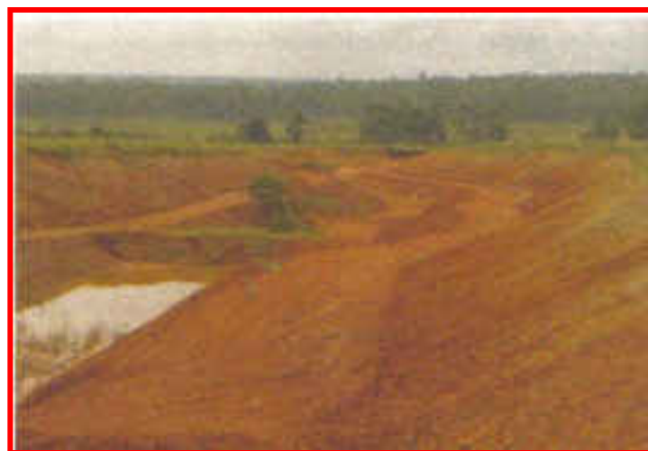
Erosão antes e após a intervenção – DF - 070
